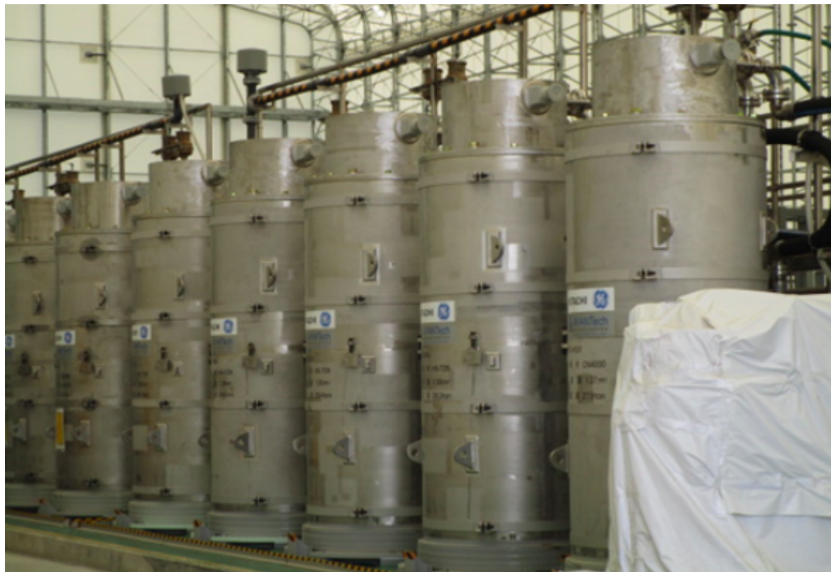
「多核種除去設備（ALPS）」
